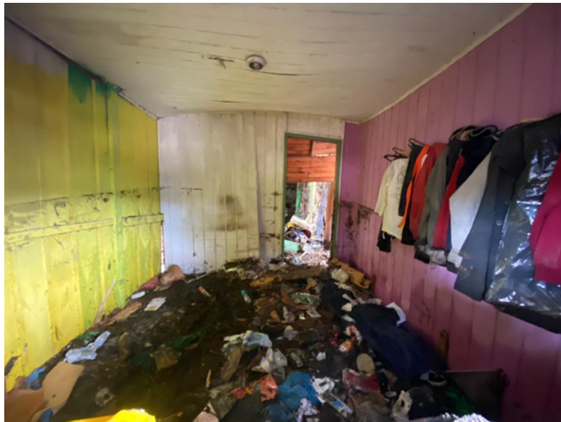
Figura 3. Área interna de residência afetada pelo desastre ambiental da Lagoa da Conceição/SC
